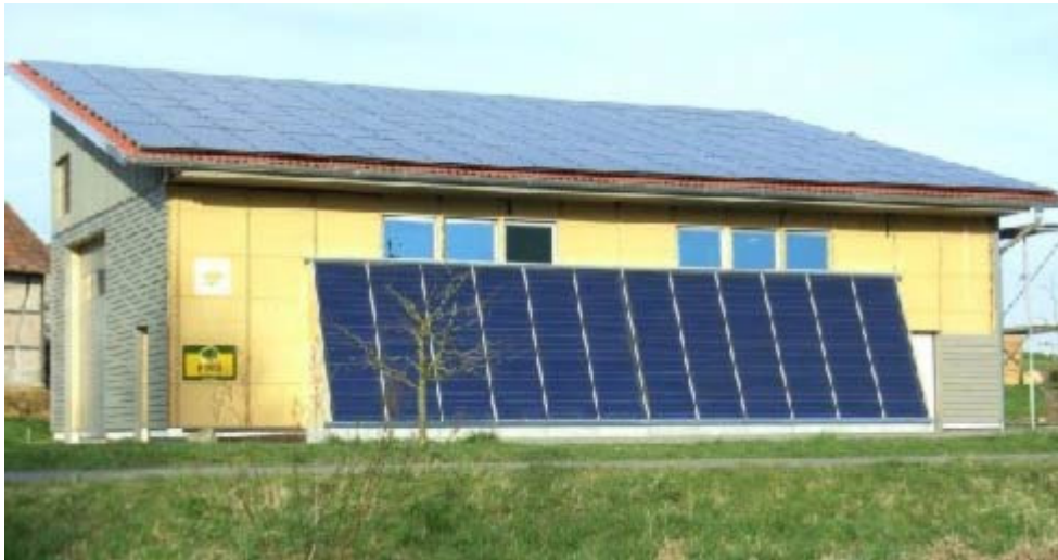
Photovoltaik-Dach plus thermische Fassadenkollektoren für die Energieautonomie. Foto: Klaus Schmitt
