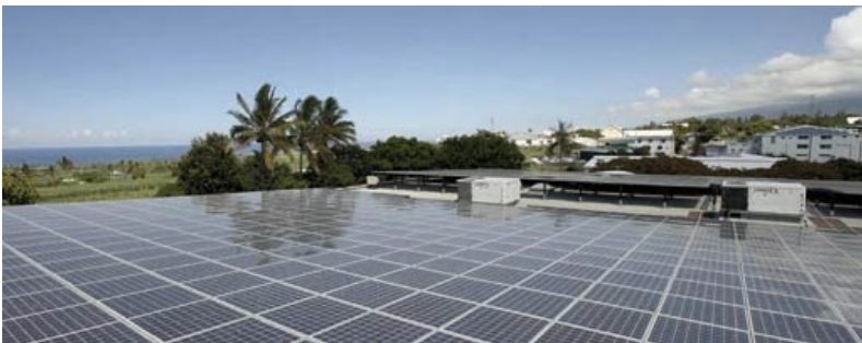
Megawatt-Solarkraftwerk auf La Réunion. Quelle: Sputnik Engineering AG
