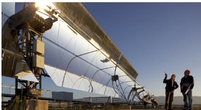
Concentrating Solar Power plant. Courtesy: MAN Ferrostaal AG; Dressler
