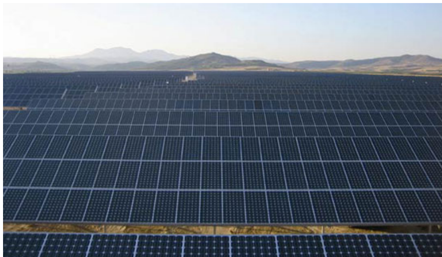
Grenzenlos solar: Die aus kristallinen Modulen von aleo Solar bestehende Freilandanlage "Vidana" mit vier Megawatt Leistung ist nur eines von vielen Solarkraftwerken in Spanien. Foto: Aleo Solar.
