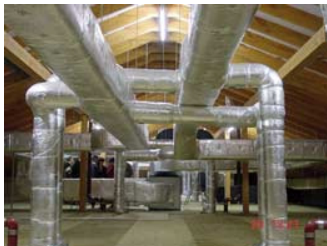
Komplexe Wärmeverteilung: Lüftungssystem im Dachgeschoss der Rehaklinik.
