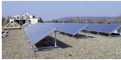
Blick auf einen der beiden Teile des Kollektorfeldes der Solaranlage der Albtherme Waldbronn. Foto: Hochschule Offenburg
