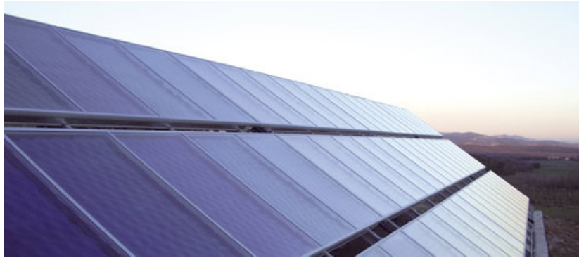
Solarthermie XXL: viel mehr als nur warmes Wasser. Foto: BSW-Solar
