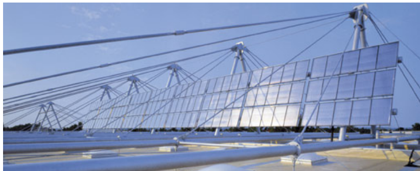
Großkollektor der "Nullemissionsfabrik" der Solvis GmbH in Braunschweig. Foto: Solvis; C. Richter
