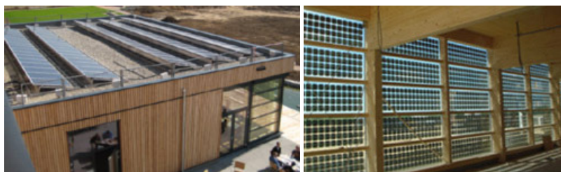
Aufdach-Solarstromanlage und transparente Photovoltaik-Fassade.
