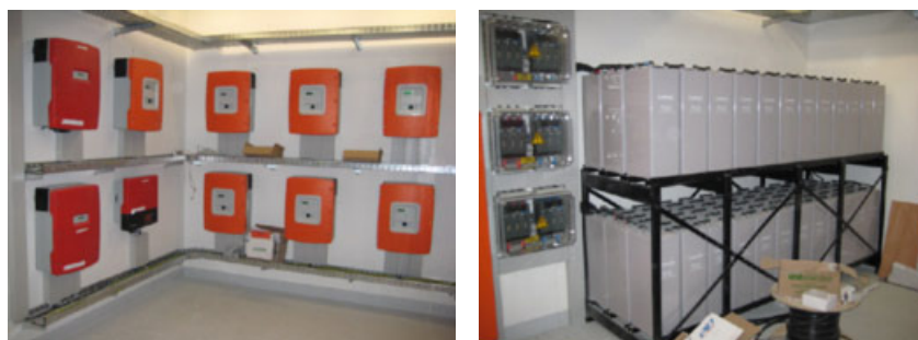
Sunny Backup: Mehrere Wechselrichter und ein großer Batteriesatz ermöglichen Selbstversorgung mit Solarstrom für mehrere Tage.
