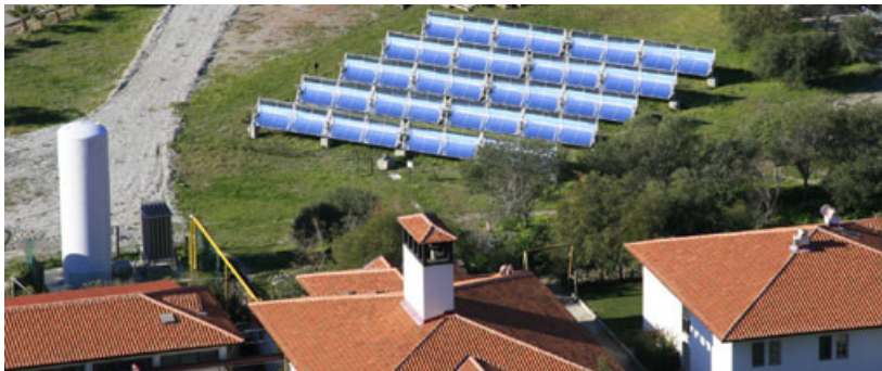
Parabolrinnenkollektoren versorgen ein Hotel in der Türkei mit Prozesswärme zur solaren Kühlung und für die Wäscherei. Foto: MAN Ferrostaal AG; de Riese
