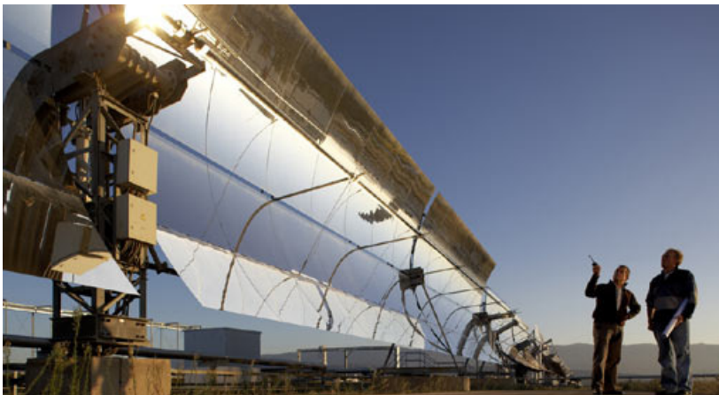
Parabolrinnenkraftwerk (Concentrating Solar Power). Foto: MAN Ferrostaal AG; Dressler
