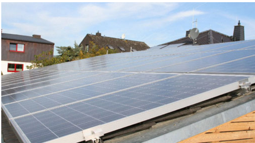
Photovoltaik-Anlage auf dem Dach: 61 m 2 Modulfläche; Nennleistung 7,59 kWp. Quelle: Clemens Dahl, Architekt.
