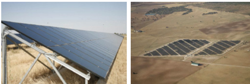
Aufgeständerte CIS-Module, CIS-Photovoltaikanlage.
