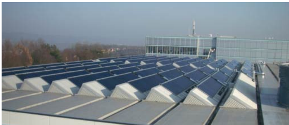
Solare Heizung und Kühlung: Solarkollektorfeld mit 1.330 m 2 Bruttofläche auf dem Dach der Festo AG & Co. KG in Esslingen. Foto: Paradigma Energie- und Umwelttechnik GmbH & Co. KG.
