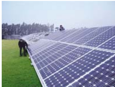
Solar-Kraftwerk (1,25 MW) in der Tschechischen Republik. Quelle: ANTARIS SOLAR
