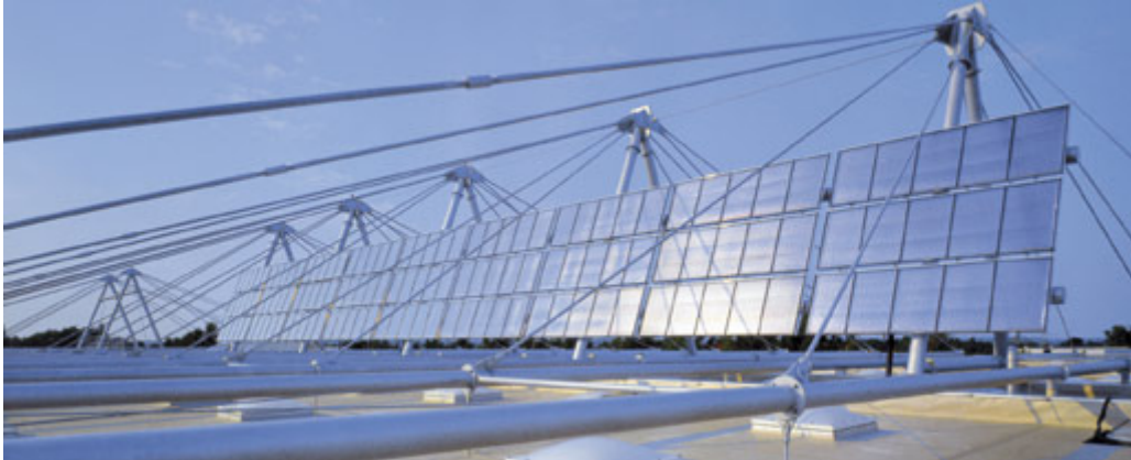
Großkollektor der "Nullemissionsfabrik" der Solvis GmbH in Braunschweig. Foto: Solvis; C. Richter
