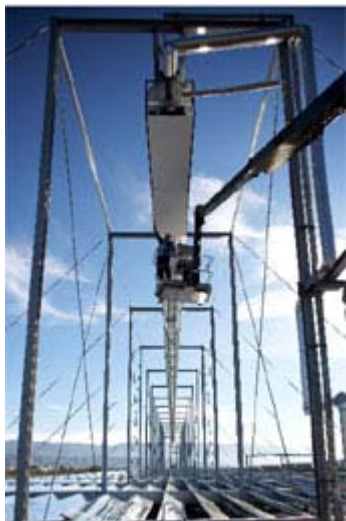
Fresnel-Kollektor auf der Plataforma Solar de Almería
