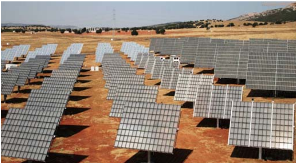
Konzentrator-PV-Kraftwerk des ISFOC in Puertollano (Spanien). Bild: Denis Lenardic; pvresources.com
