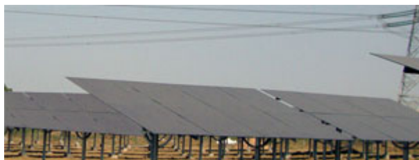
Solarpark mit Moser Baer-Modulen in Maharashtra
