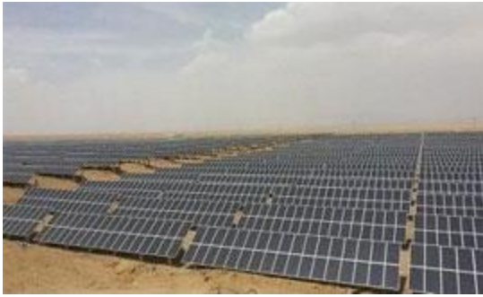
In Nordwestchina gingen 2013 viele Photovoltaik-Großkraftwerke in Betrieb. (Foto: Goldpoly)
