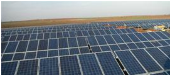
Photovoltaik-Referenzkraftwerk von EGP
