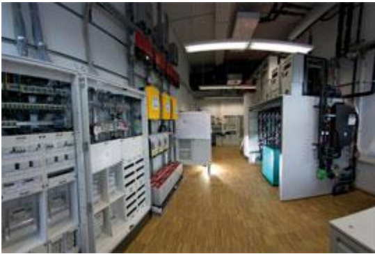
Blick ins Energiespeicher-Labor des Fraunhofer ISE
