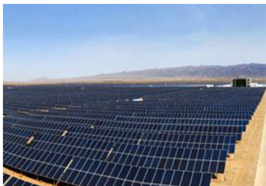
In China wurden 2014 über 10 GW Photovoltaik-Leistung installiert
