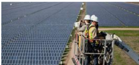
Lamesa ist das dritte und größte Photovoltaik-Projekt von RES in Texas
