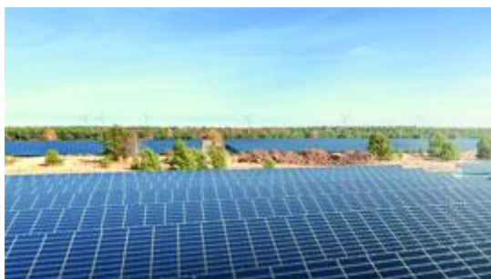
Photovoltaik-Kraftwerk mit Wechselrichtern von SMA
